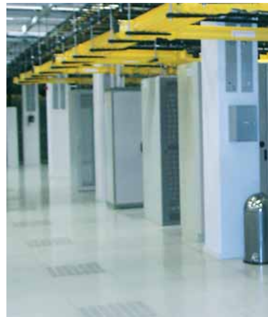
In einem professionell betriebenen Rechenzentrum sorgen Klima- Sicherheits- und Berechtigungskonzepte sowie Videoüberwachung
